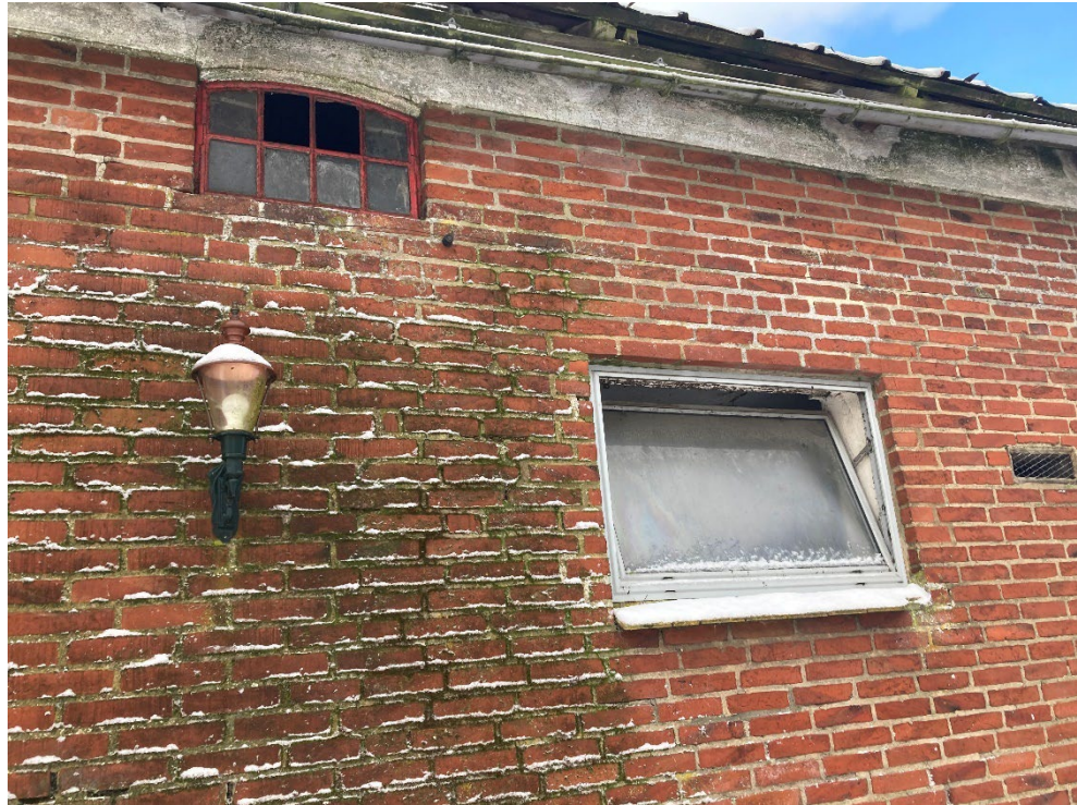
Figur 4-30 Ituslåede vinduer samt hul under tag er mulige adgangsveje for flagermus
