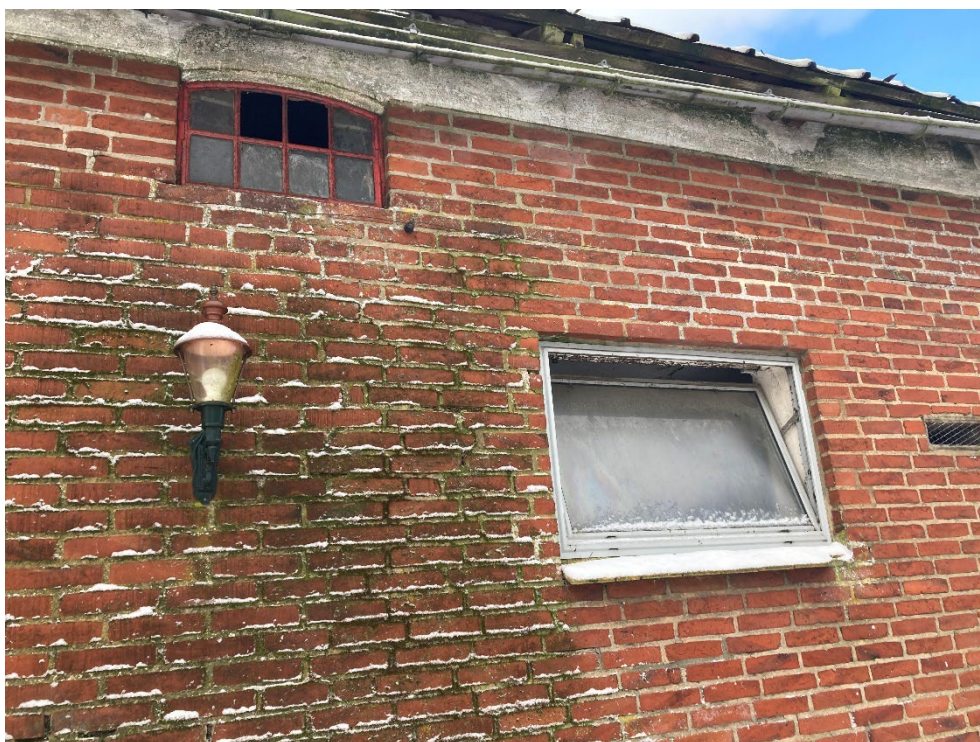
Figur 3-75 Ituslåede vinduer samt hulhed under tag er mulige adgangsveje for flagermus
