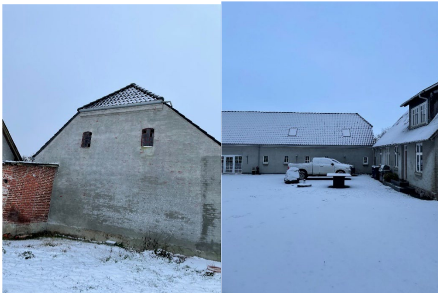
Figur 4-26 Nybygget slagterbutik og stuehus, på bagsiden er ituslåede vinduer.
