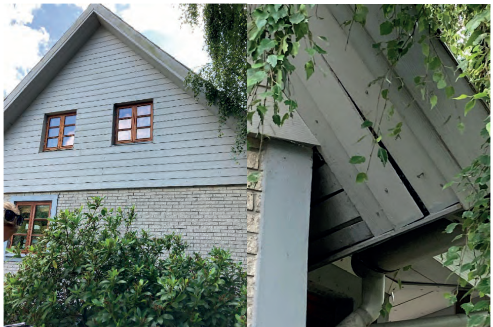
Figur 3-39 Hovedhuset har løse brædder i tagkonstruktionen ved tagrenden
