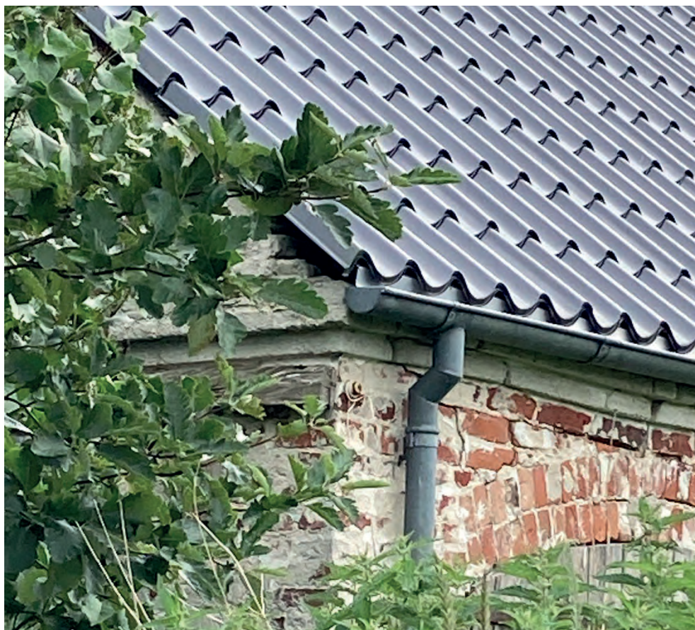
Figur 3-18 Nordlig gavl af mindre bygning. Det ses at der mangler mursten nær tagrende mellem tag og gavlen. De manglende mursten former en sprække flagermus potentielt kan benytte til at komme ind i bygningen.
