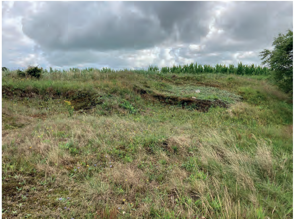
Figur 3-54 Skråning med løst sandet jord og lav vegetation nord for E20S.
