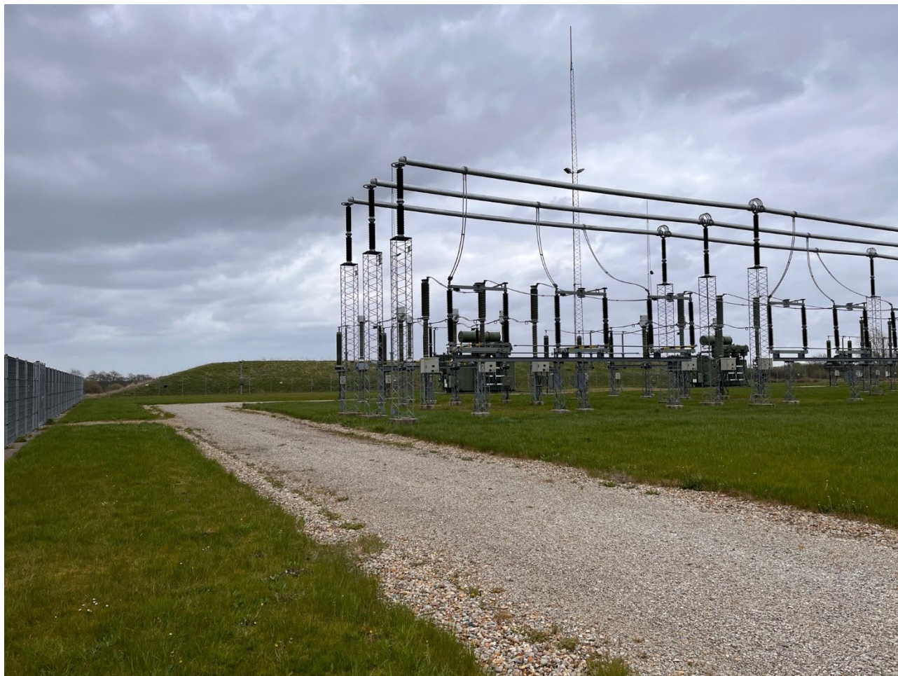
Foto af eksisterende højspændingsstation med jordvold i baggrunden. (Energinet)
